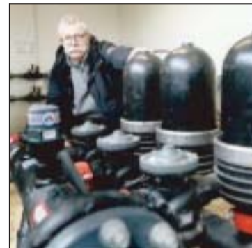
Le petit local technique près du bassin de décantation.
